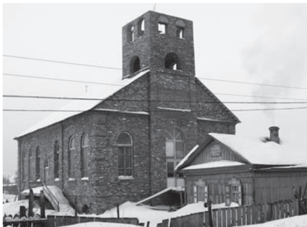
Строительство здания церкви в Спасске-Дальнем, январь 2011 года. На переднем плане – старое здание, используемое с 1960-х годов. Фото автора
